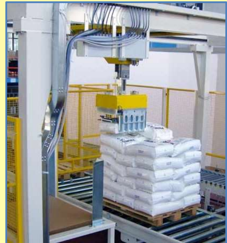
Impianto di movimentazione a fine linea
